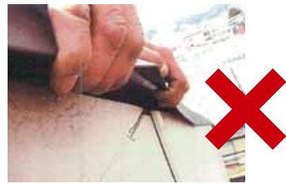
ケラバの防水処理が不適切だったため雨漏りしてしまった事例
