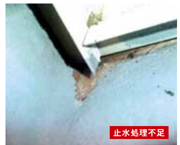
防水立上り端部の施工不良
