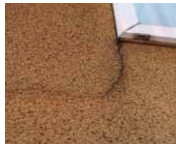
<開口部廻りのひび割れ>
