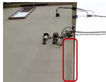
<出隅部のクラック>
