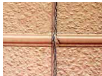
<シーリングの劣化による亀裂>
